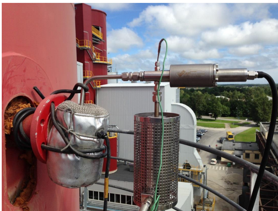
Joonis 2 Soojuselektrijaama korstna mõõtepunkt
